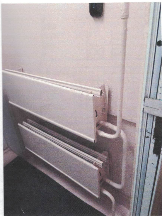
Фото №2. Батареи в тамбуре
